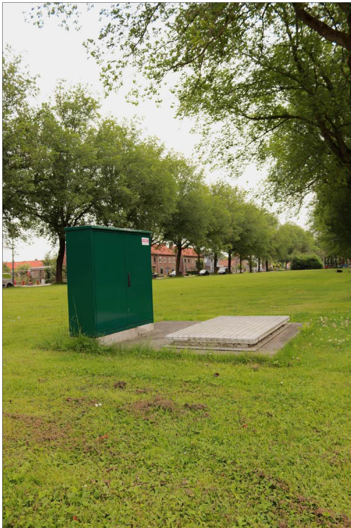
Rioolgemaal in Wieringerwerf
